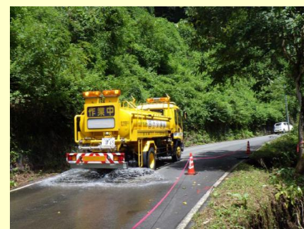
散水車による道路散水作業 鳥取県八頭郡八頭町（県道麻生国府線）
