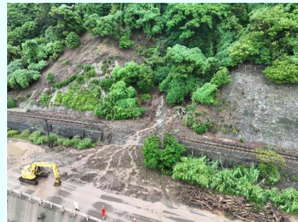
法面崩落被災状況（国道191号） 山口県下関市豊浦町
