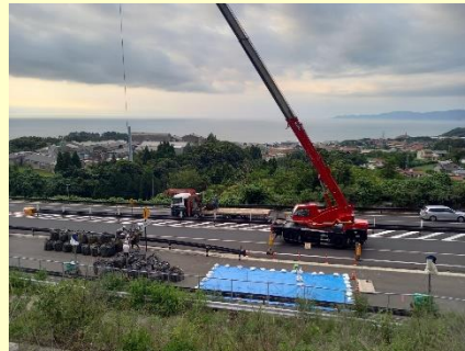
路面変状箇所の応急対策作業状況 島根県出雲市多伎町（多伎朝山道路）
