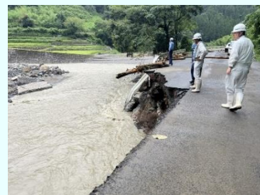
佐治川の洗掘被災箇所 鳥取県鳥取市佐治町
