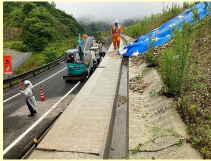
法面土砂流出の応急対策 (広島市安芸区：東広島バイパス)
