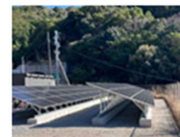
太陽光発電施設
