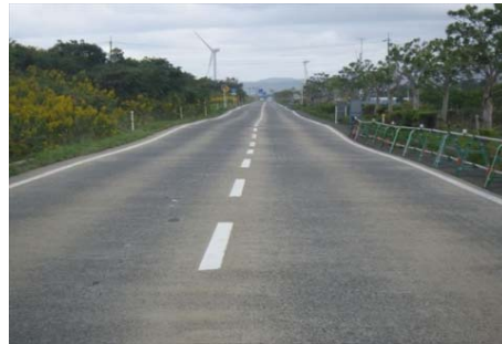
▲国道9号：地震による路面のうねり
