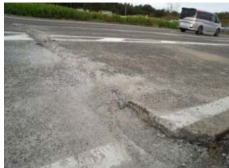
▲国道9号：地震による舗装の損傷
