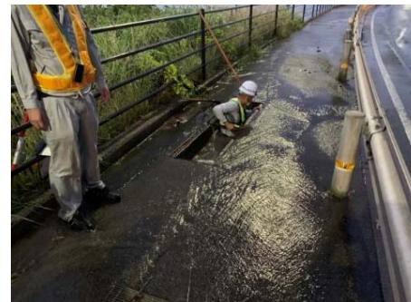
▲国道9号：水路閉塞による路面冠水
