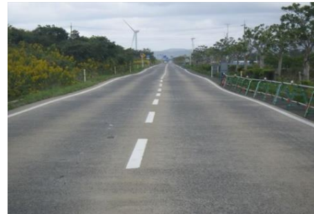
▲国道9号：地震による路面のうねり
