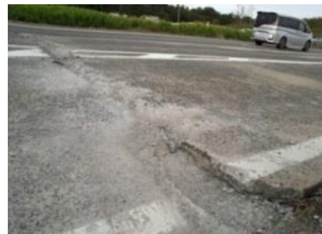
▲国道9号：地震による舗装の損傷
