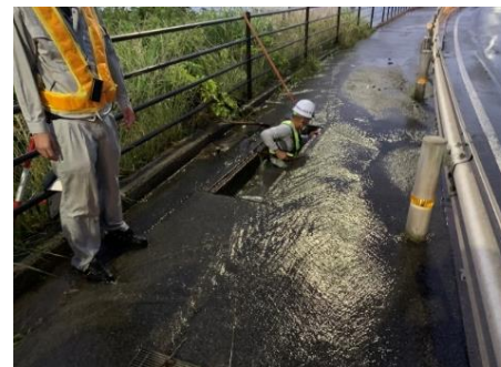
▲国道9号：水路閉塞による路面冠水
