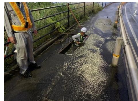
▲国道9号：水路閉塞による路面冠水
