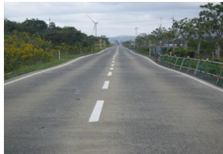
▲国道9号：地震による路面のうねり
