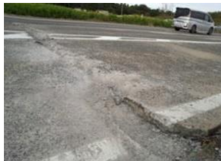
▲国道9号：地震による舗装の損傷
