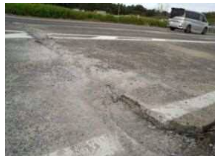
▲国道9号：地震による舗装の損傷
