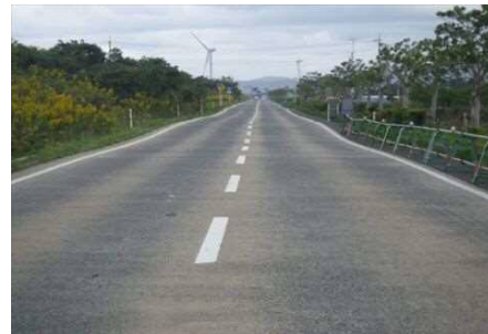
▲国道9号：地震による路面のうねり
