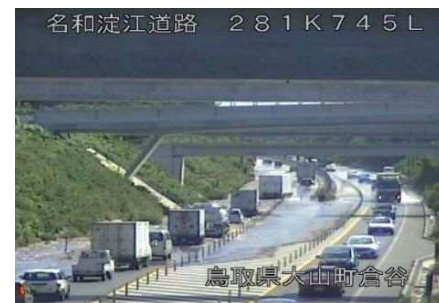
▲山陰道：豪雨による浸水
