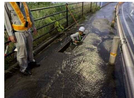
▲国道9号：水路閉塞による路面冠水
