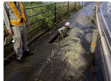
▲国道9号：水路閉塞による路面冠水
