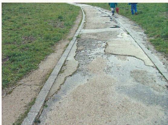
舗装の剥がれ
