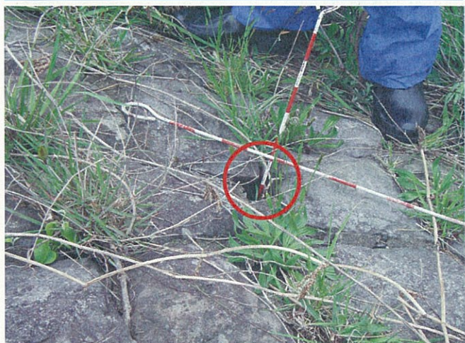
石張護岸詰石外れ (天神川右岸河口付近)
