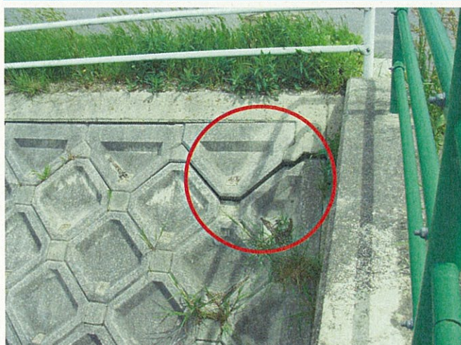
護岸ブロックの沈下 (国府川左岸5k800付近)
