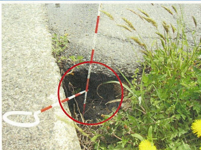
堤防法肩部吸い出し (天神川右岸11k900付近)
