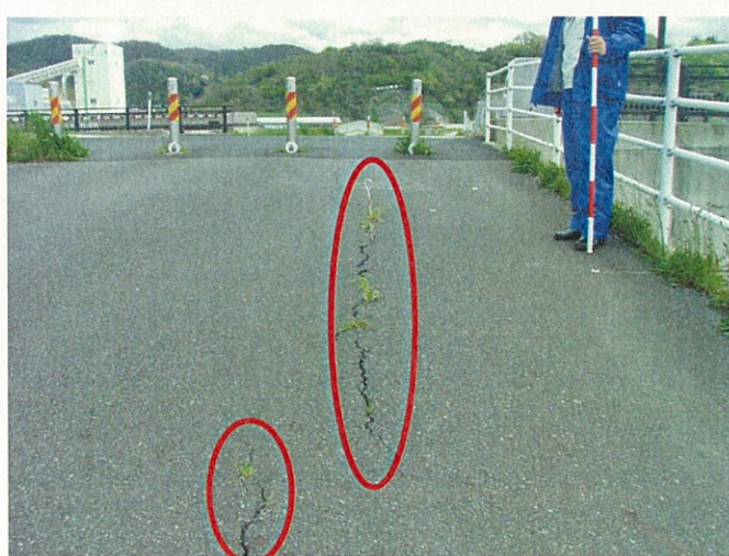
堤防天端ひび割れ (小鴨川左岸3k200付近)
