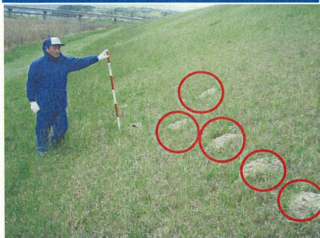
堤防にモグラの穴 (天神川左岸4k230付近)
