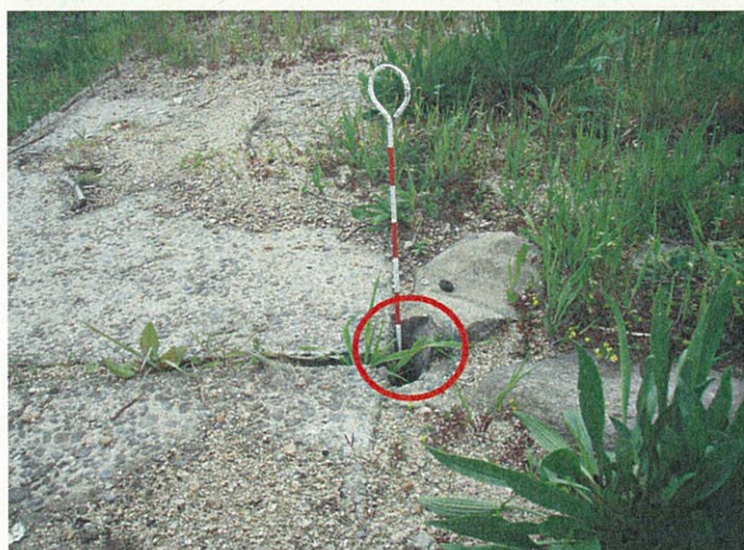
石張護岸に穴(20cm) (天神川左岸0k150付近)
