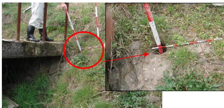
石積護岸の空洞30cmの穴 天神川左岸9k800付近(倉吉市円谷)
