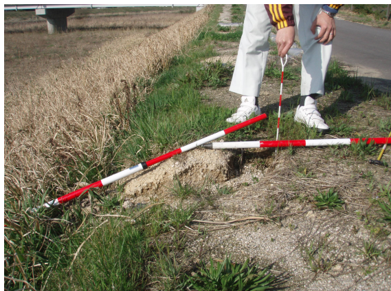
堤防法肩の崩れ 小鴨川右岸9k400付近(倉吉市鴨河内)
