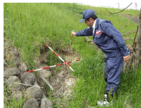
緊急対応箇所 堤防の洗掘(三徳川)
