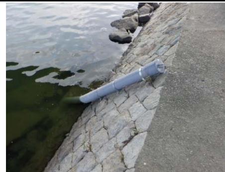
濁度計保護管の設置例
