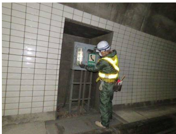
■設備点検（トンネル非常用施設）
