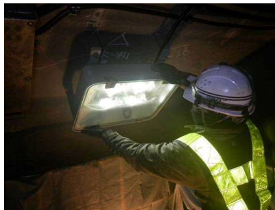
■設備点検（トンネル照明）
