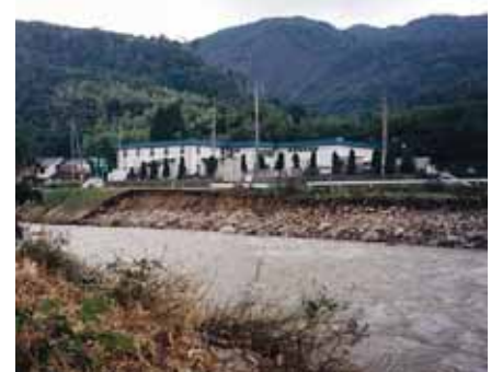
平成 10 年 10 月洪水による三朝町牧地区における護岸の被災状況
