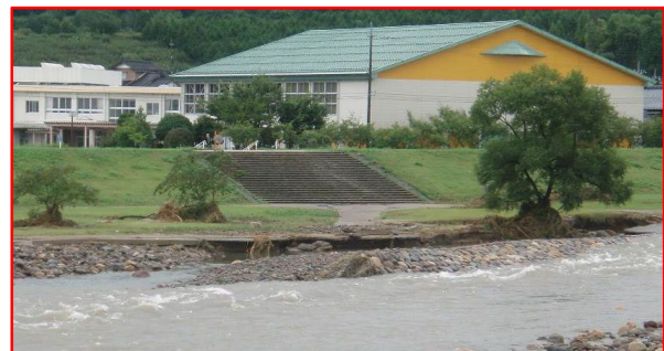
図 5.1.3 平成 23 年(2011 年)9 月洪水による 倉吉市下大江地区における護岸の被災状況
