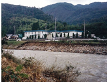
平成 10 年(1998 年)10 月洪水による三朝町牧地区における護岸の被災状況
