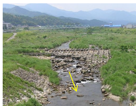
河床低下対策が課題の小鴨川(関金付近)
