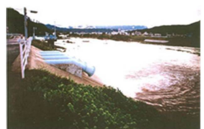
平成 10 年(1998 年)10 月台風洪水 倉吉市和田地区の排水機場稼働状況
