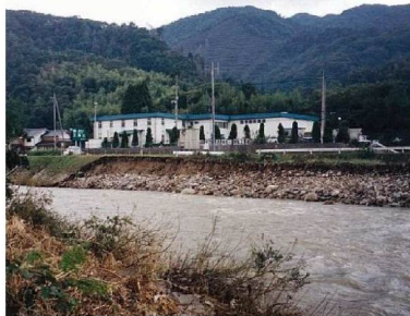
平成 10 年 10 月洪水による三朝町牧地区における護岸の被災状況
