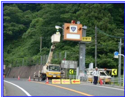
警報設備点検
