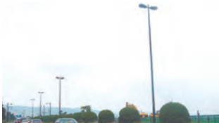
夜間の視認性を向上させる道路照明
