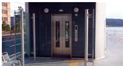
【穴道湖夕日スポット】護岸と駐車場を結ぶ地下道に設置されたエレベータ。
