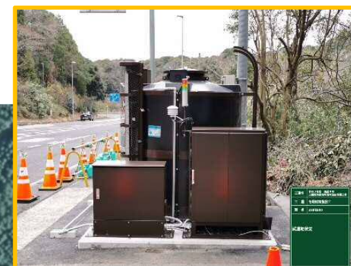
散布装置本体設置状況
