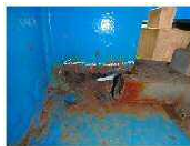
橋梁の損傷状況(雲南市 第1殿河内橋)
