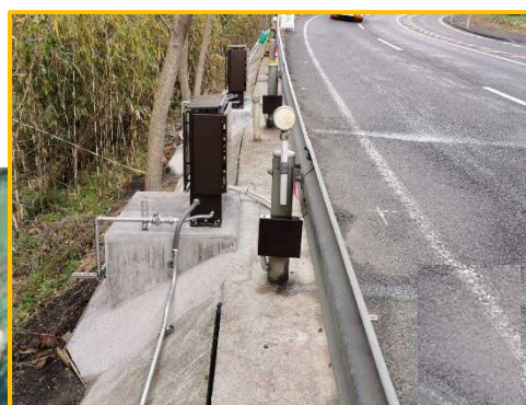
散布(噴射)装置設置状況
