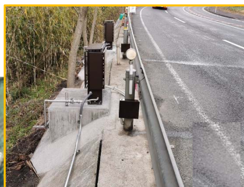
散布(噴射)装置設置状況
