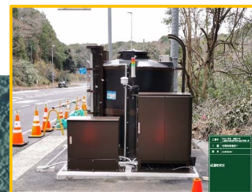
散布装置本体設置状況
