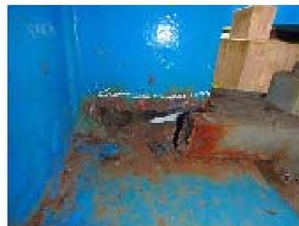
橋梁の損傷状況(雲南市 第1殿河内橋)
