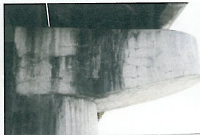
橋脚部分のひび割れ
