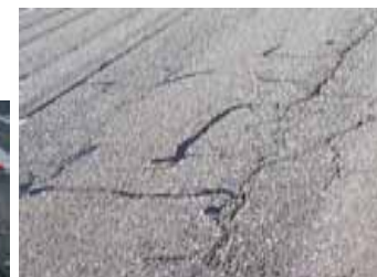
舗装のひび割れ
