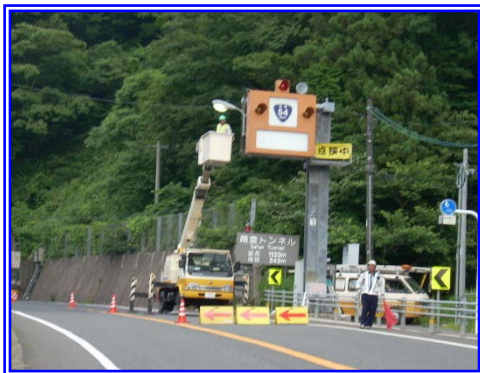
警報設備点検
