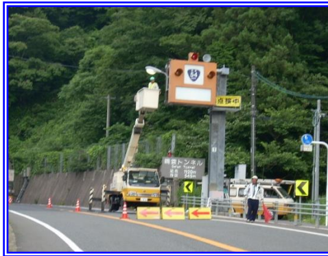
警報設備点検
