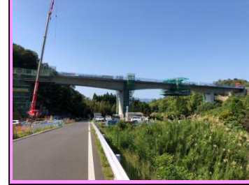
4. 二部高架橋PC上部工事 概要：橋梁上部 受注者：榊日本ビーエス
