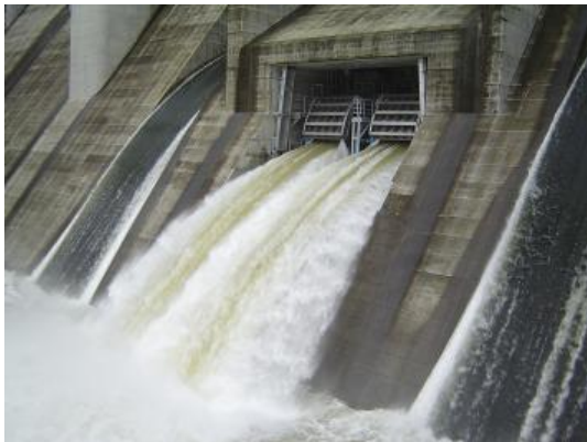
(←) 灰塚ダムの 「環境用水放流設備」 平成21年7月21日 17:45頃の様子
