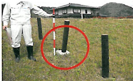
③進入防止柵の基礎が出ている（下土師環境護岸）
