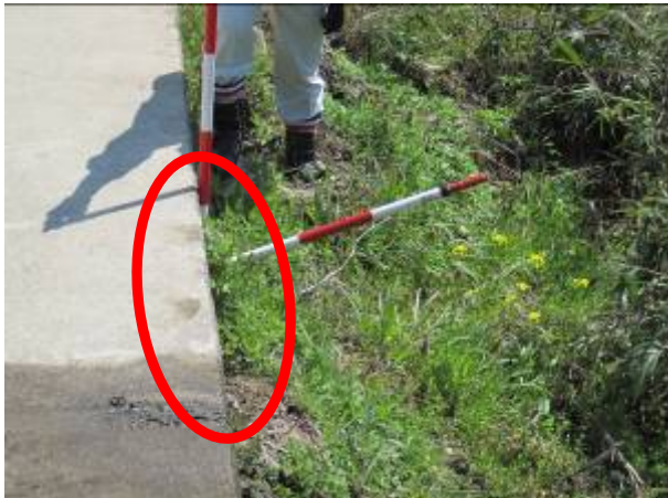
河川管理者において補修を行う。
