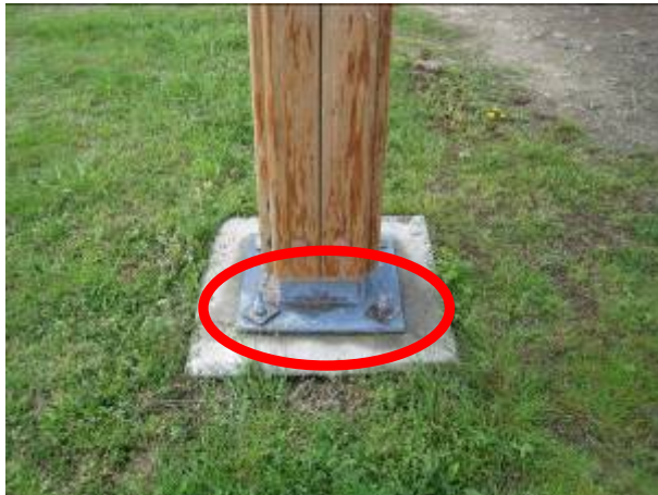
占有者において補修する。
