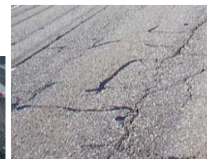
舗装のひび割れ
