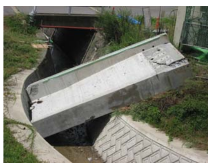
落下したセグメント桁
