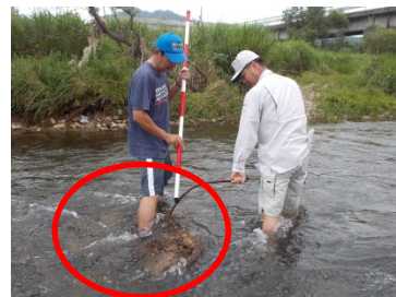
鉄筋混じりのコンクリート殻を発見。
