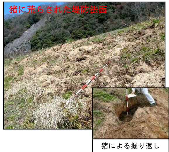
写真 3-4 猪に荒らされた堤防法面
