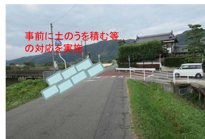
右岸取付部:堤防が低い 16
