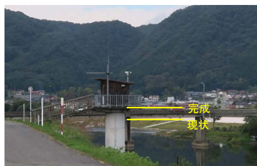
桁下余裕高不足
