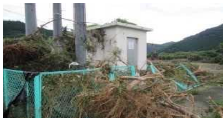
他ダムにおける放流警報設備の浸水後の状況
