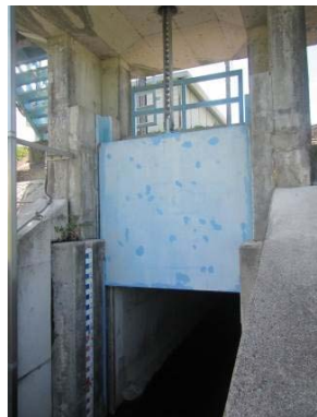
開閉操作を必要とするゲート
