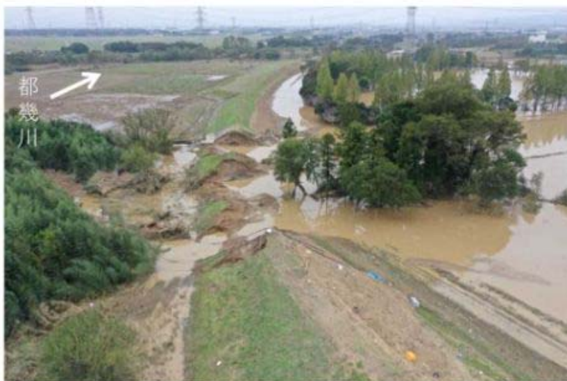
都幾川0.4k右岸 決壊箇所
