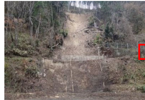
山腹崩壊（施工前）
