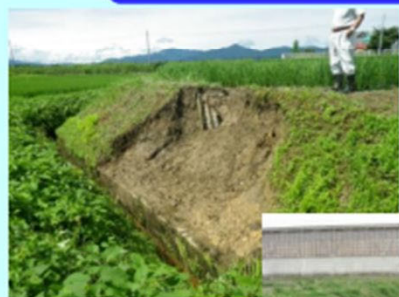
水路法面の崩壊
