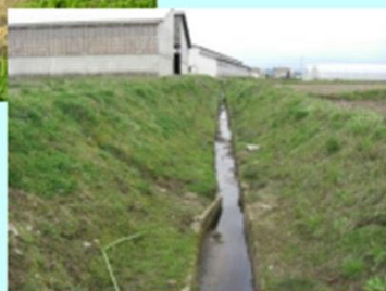
水路側壁の倒壊
