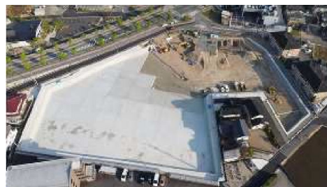
雨水貯留施設 （三次市願万地地区）
