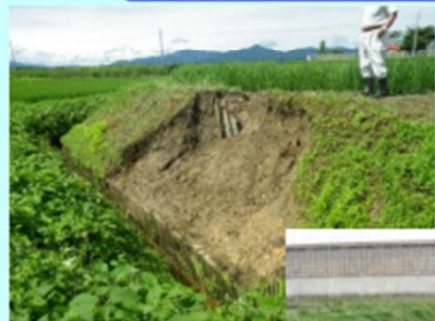
水路法面の崩壊
