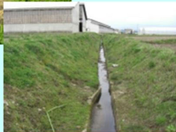
水路側壁の倒壊
