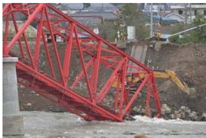
千曲川左岸側(上田)で崩落した別所線の鉄橋 (写真出典: 信濃毎日WEB)
