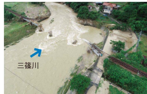
平成30年7月豪雨によるJR橋梁流失状況 (広島市安佐北区白木町三田)
