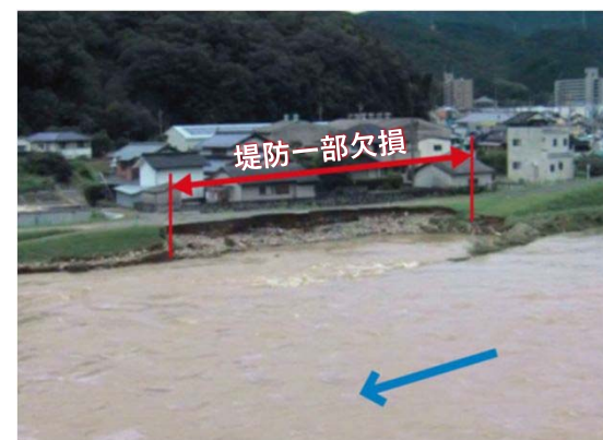
平成30年7月豪雨の被災状況 (三篠川右岸4k200付近)
