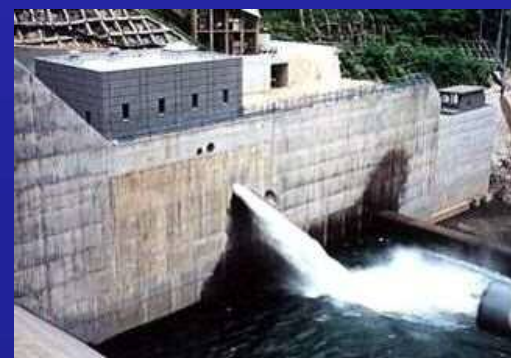
利水放流設備からの放流状況
