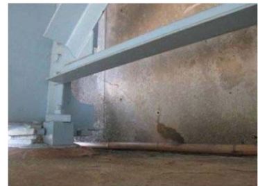
【管理橋のひびわれ H25】
