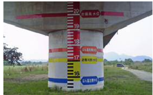
水位表示板（総社大橋）
