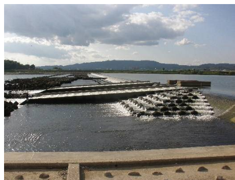
老朽化が進行している潮止堰
