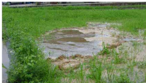
漏水に伴う噴砂の発生状況 (平成 18 年 7 月洪水、総社市清音地区)
