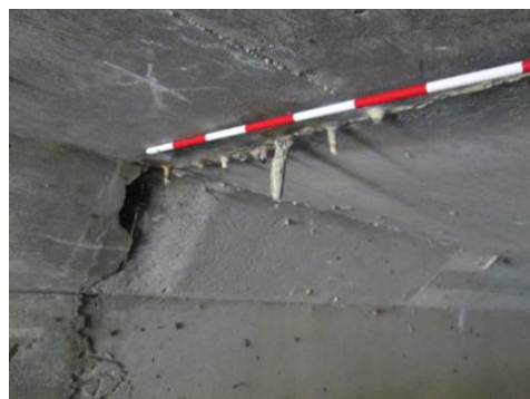
施設の老朽化の事例
