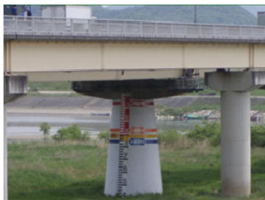
水位表示板（備前大橋）
