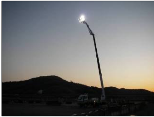
照明点灯状況
